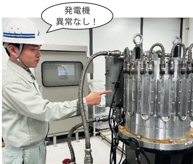
発電機 (右) を点検する職員
